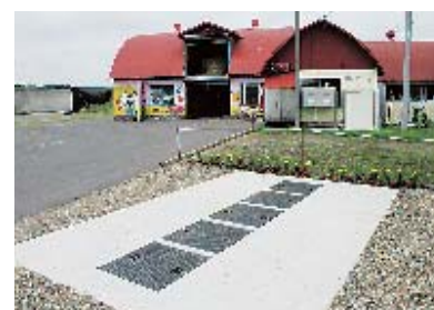
牛舎に隣接して設置された 搾乳廃水処理ユニット
