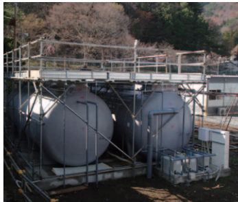
▲東日本大震災時の仮設浄化槽(PCN型×2系列)
