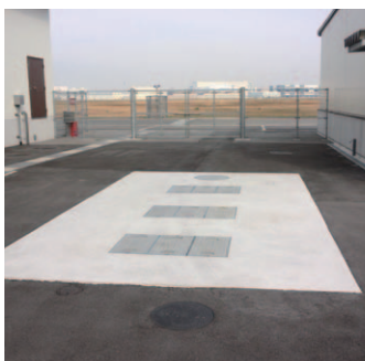
▲センターに設置されている浄化槽
