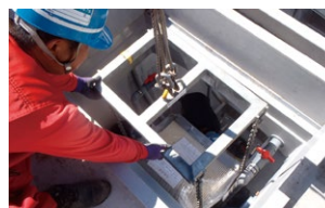
▲膜処理ユニット(FRP管体内)
