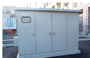
▲制御盤が組み込まれた機械室
