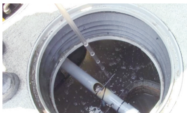
▲嫌気ろ床のガス抜き
