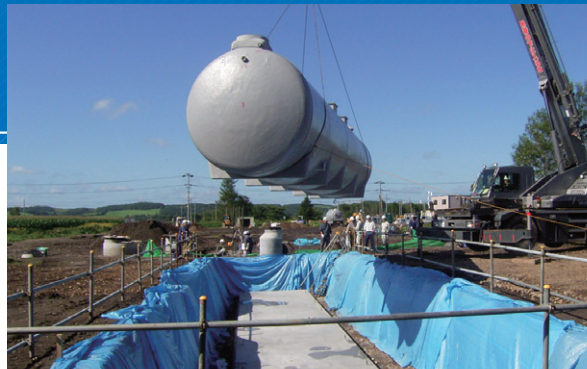
▲工場製作型極小規模処理施設(膜分離型)第一期工事の様子
