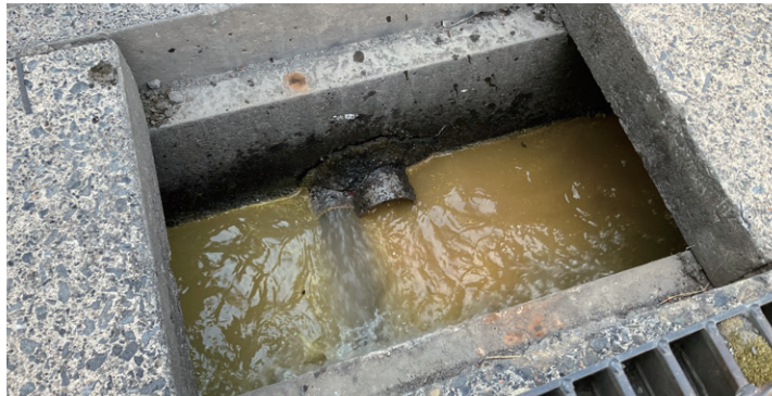
▲廃水が側溝へ放流される様子
