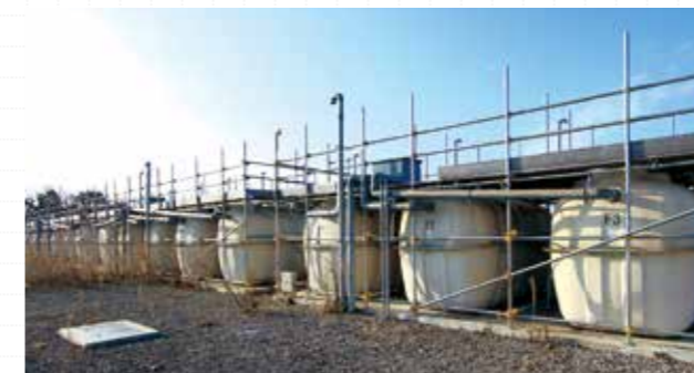
益城町テクノ仮設団地に設置されているフジクリーンの浄化槽(CSL II-50型×20基、CSL II-45型×8基)
