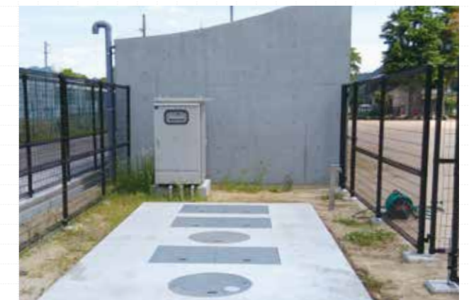
マンホールトイレに対応した浄化槽
