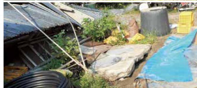
地震による浄化槽および浄化槽周辺の被害状況(写真提供:公益社団法人熊本県浄化槽協会)
