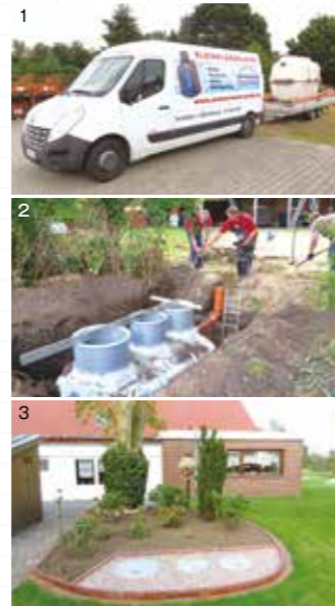
1.浄化槽を運搬するサービスカー 2.農場での施工風景 3.設置後のようす
